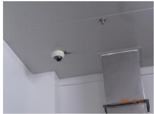
1区危废暂存间监控系统
