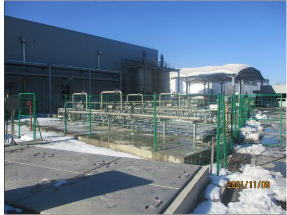
2 区化学品地下罐区
