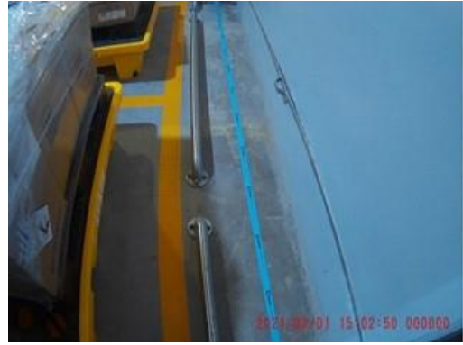
1区化学品仓库截流沟内泄漏报警装置
