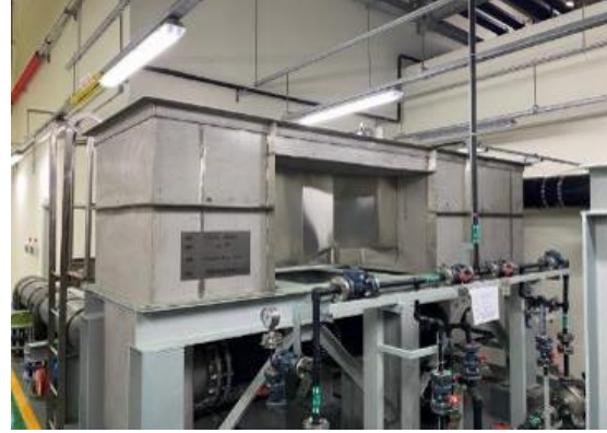
车间废水排口
