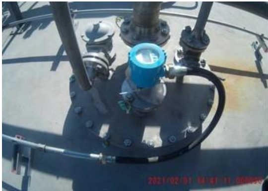
地下罐体液位监控
