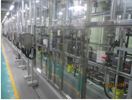
2区污水处理站药品室防泄漏截流沟及防护罩
