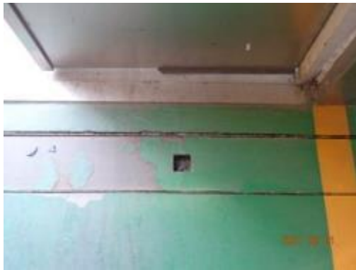
1区危废暂存间截流沟防泄漏装置
